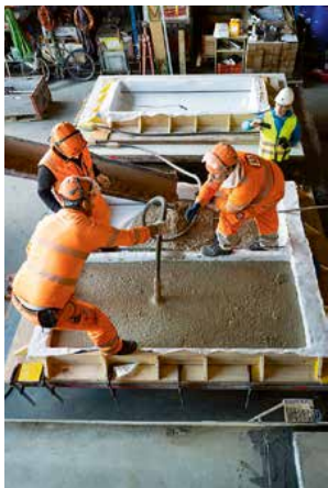
Bauarbeiter setzen die sogenannte Vibriernadel ein. Sie hilft, die eingeschlossene Luft zu entfernen.
