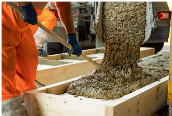
Der Flüssiglehm wird wie Beton in eine Schalung gegossen, wo er aushärtet.
